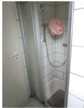
Vorher: Die Duschtasse liegt 20 Zentimeter unter Bodenniveau, die Schiebetür verengt den Durchgang.
